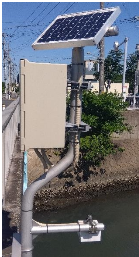
河川水位観測計器 （危機管理型水位計） 菊田川・谷津川に設置
