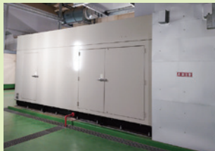
⑥【水道】非常用自家発電設備
